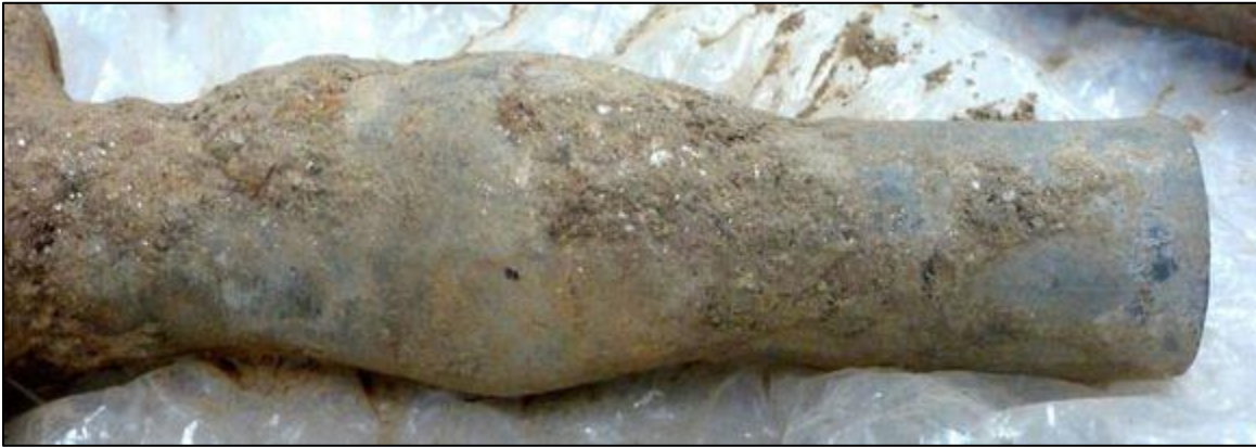
Tubería de plomo en una llave de corte general. Fuente: Philadelphia Water
